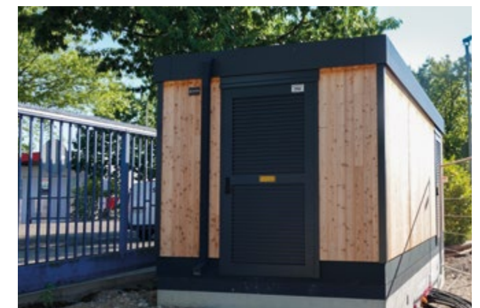
Erstmals in Süddeutschland in Betrieb: Die neuen Trafostationen aus Holz mit begrünbarer Dachfläche auf dem Streck-Firmengelände in Freiburg
